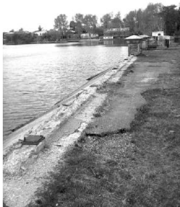
Исчезло чугунное ограждение вдоль плотинки
